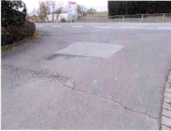
Abbildung 4: Einfahrt Frühlingsstraße - starke Straßenschäden.
